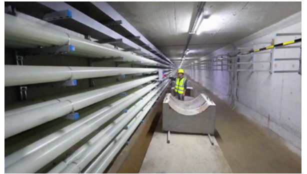
广东肇庆综合管廊
